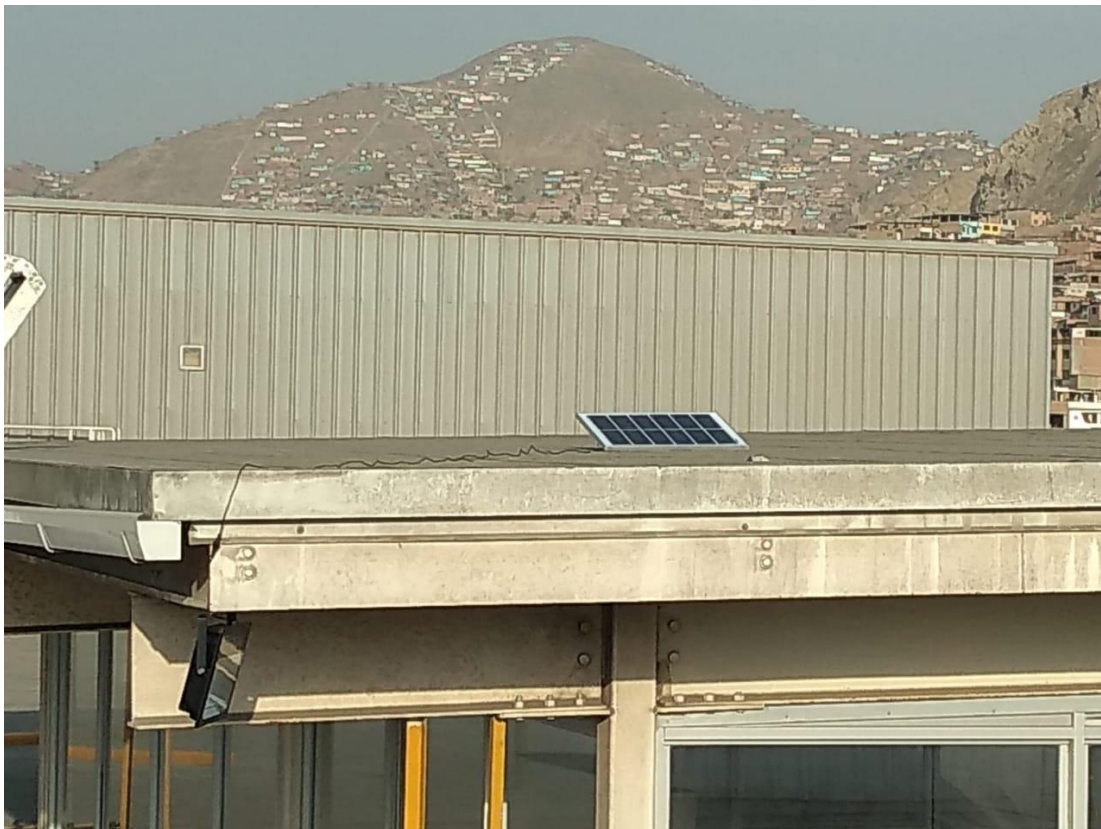
(Imagen referencial de instalación de nuestras lámparas solares)
